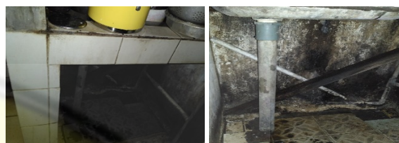
Gambar 4. Bak Kontrol Air Cucian Piring Rumah Tangga
